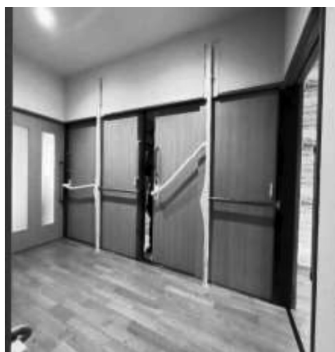
図 9 独居老人用にとりつけられた半自動引き戸装置。
