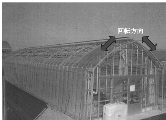
図1 内部温度を自動的に制御するフルオープン型プラスチックハウス（野田他 3) から転載）
